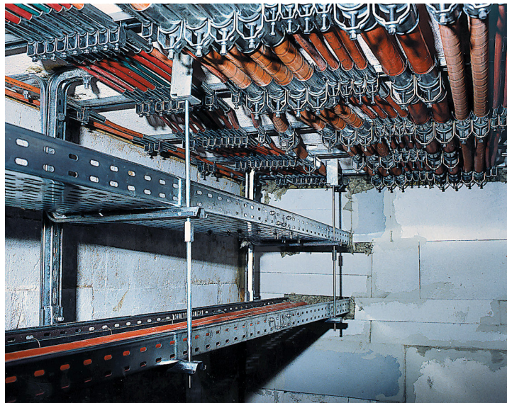
Перед тестом на пожаростойкость.
